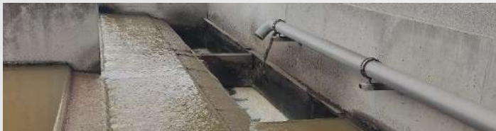
Bild einer Dosierstelle mit Optimierungspotenzial
